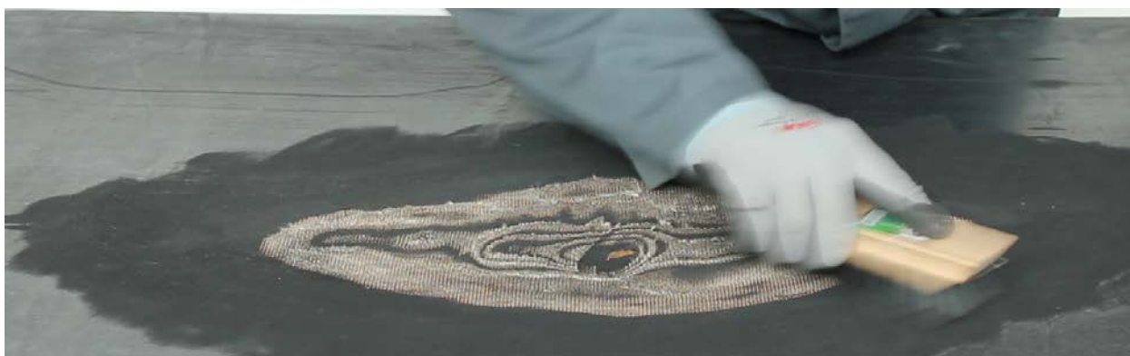
Рис. 2.6 – Очистка ленты от посторонней пыли и грязи
